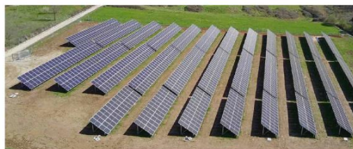
I tre impianti di medie dimensioni su terreni agricoli in Campania a Buonabitacolo garantiranno 2,41 MWp di energia pulita
